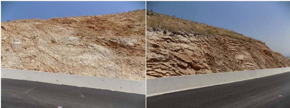
Figure 39 Foto: km 20+660 deri ne km 20+800 me shkembinjte gelqerore pllakore dhe shume te çare.
