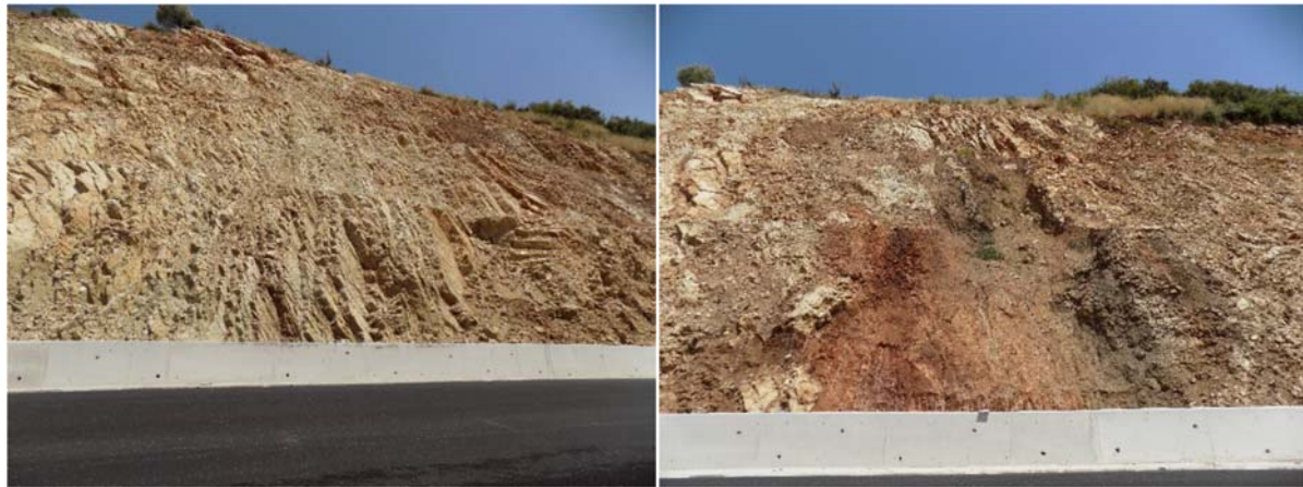
Figure 45 Foto: km 21+260 deri ne km 21+390 me shkembinjte gelqerore shtresore, te rrudhosur dhe me shume çarje.
